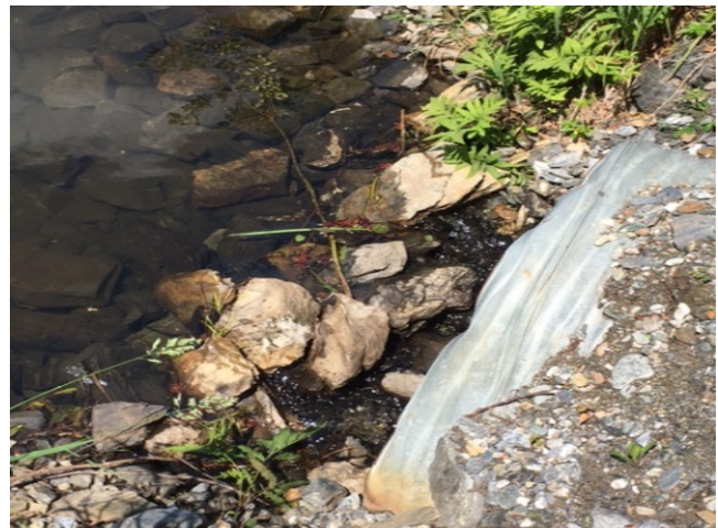
Photo 4. Ponceau endommagé, 23 juin 2016.
